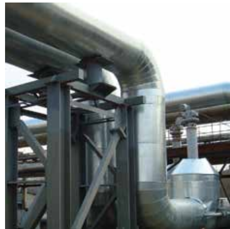
Системы вентиляции, кондиционирования и трубопроводы
